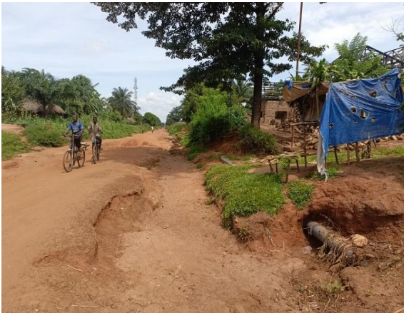
Photo 5 Traversée de la Cité de Ngandajika : Tuyaux de la Regideso
